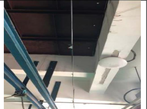
图 3.2.10 污泥干化厂房顶部的臭味吸附液喷头（利旧）
