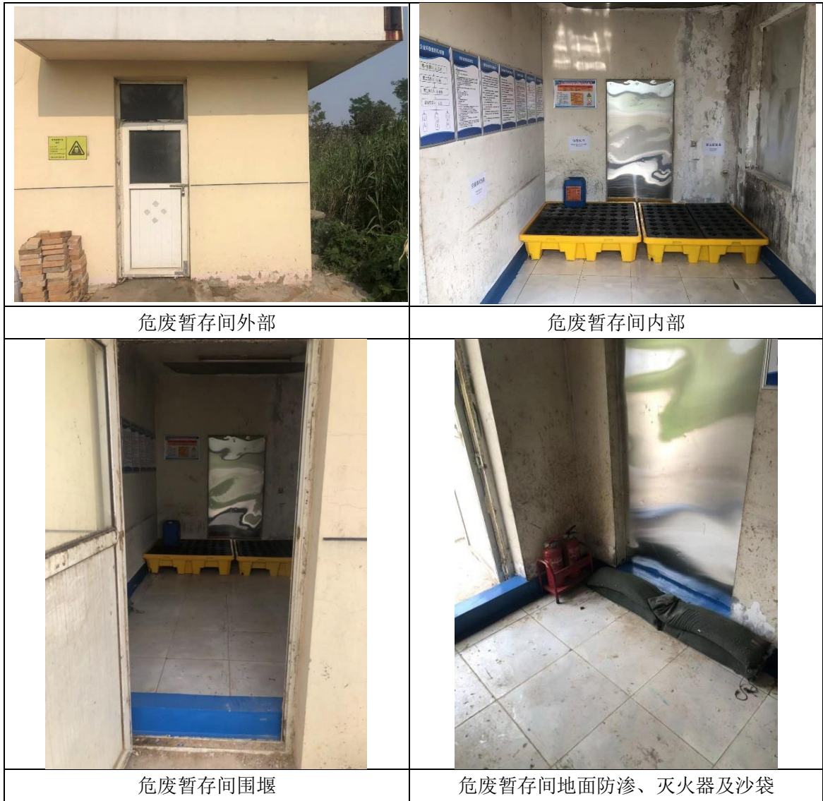
图 3.5 危险废物暂存间建设情况
