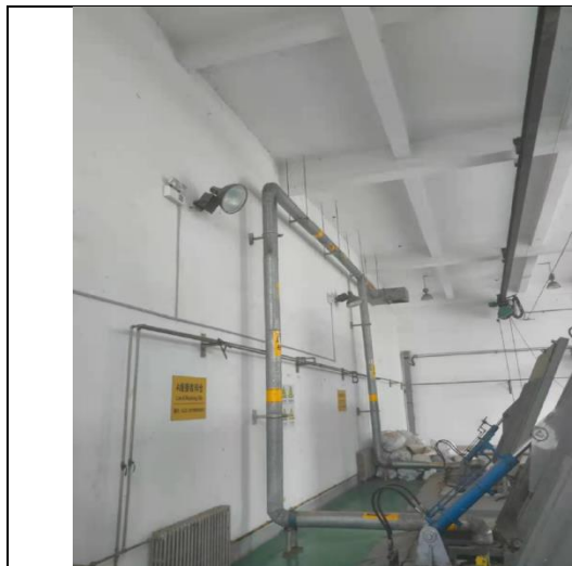
图 3.2.1 湿污泥接收间地下贮仓集气管道(利旧)
