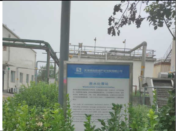
图 3.2.8 污水站各池体封闭且设集气管道（利旧）
