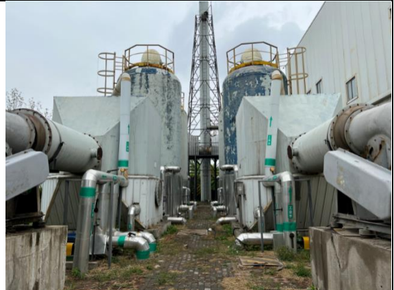
图 3.2.12 两套废气处理设备及排气筒 DA001（利旧）
