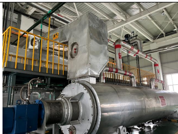
图 3.2.6 干化装置产生的废蒸气收集管道(利旧)
