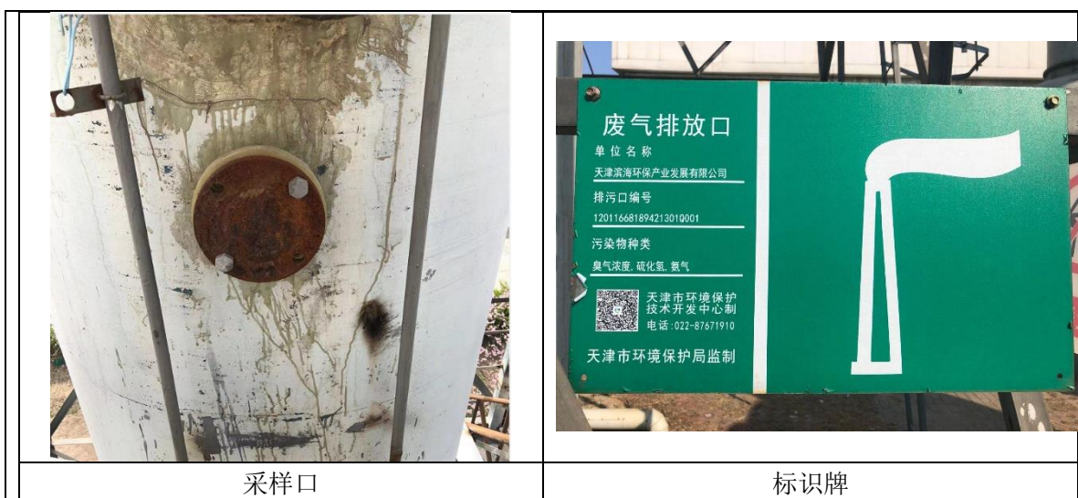
图 3.7 废气排气筒 DA001
