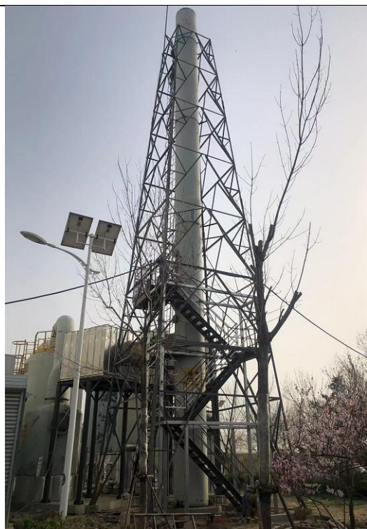
废气排气筒 DA001
